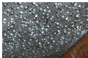
Zlá paropriepustnosť a nedostatočné odvetranie vlhkosti
